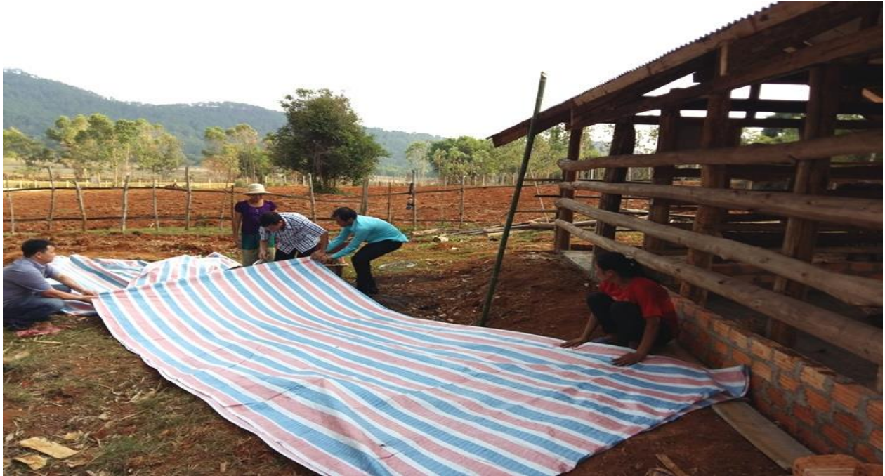
Tu sửa và chằng chống chuồng trại, mái chuồng để hạn chế tốc mái khi có bão
