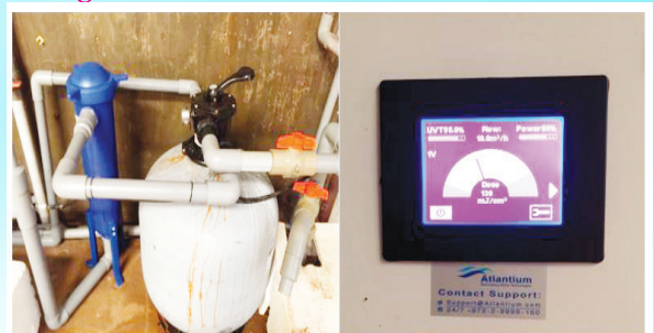
Hình 2. Hệ thống lọc áp suất, lọc tinh và đèn UV
